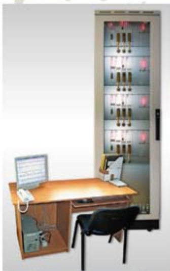
Шкаф КЭБ-2, СЗТ КЭБ-2
